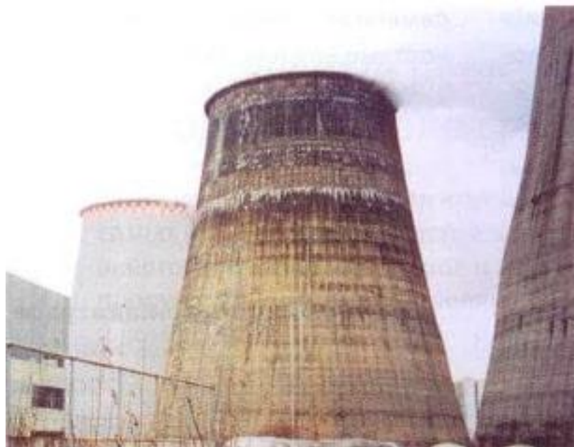
Рисунок 1.1 – Фото железобетонной оболочки вытяжной башни градирни с признаками деструкции. Заимствовано из [9].
